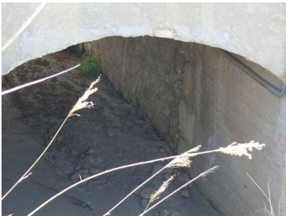
FOTO N°2: Marco de Hormigón de 3.00x2.50 m2. Obra de Paso en Carretera de las cuevas.
