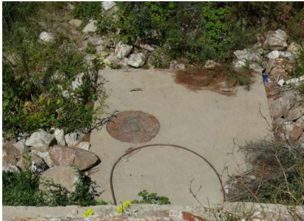
FOTO Nº51: Trapa de colector el solera del cauce
