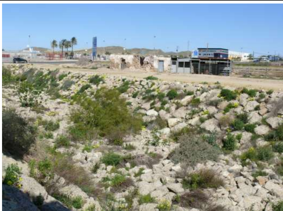
FOTO N°8: Rambla del Algarrobo con solera y taludes de escollera. Sección trapecio de 15 m base y 3 m alto, talud 1/1.
