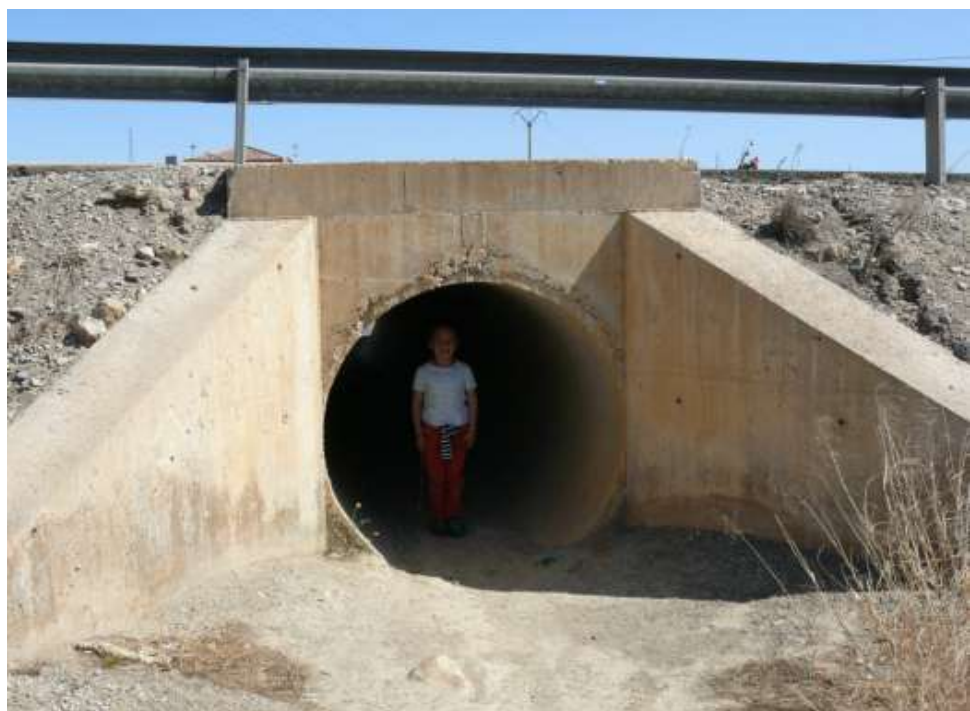
FOTO Nº23: Obra de paso de la carretera ALP116 de diámetro 1500 mm y vertido a la Rambla del Algarrobo.
