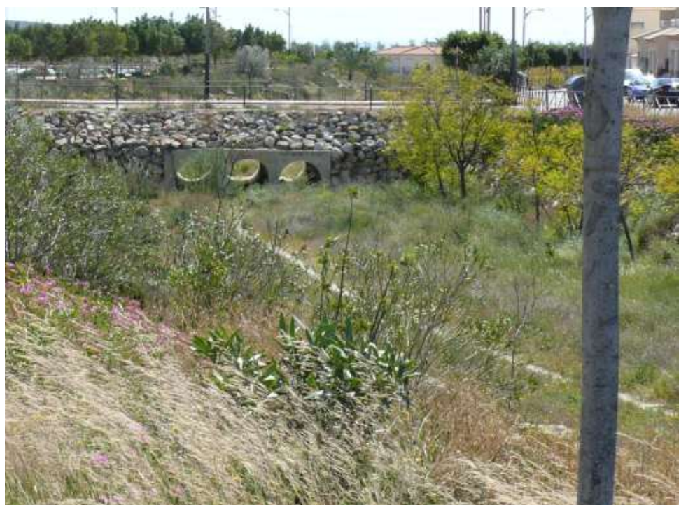
FOTO N°48: Obra de paso de vial sobre el cauce compuesta por tres tubos de PVC de 2.000 mm de diámetro.
