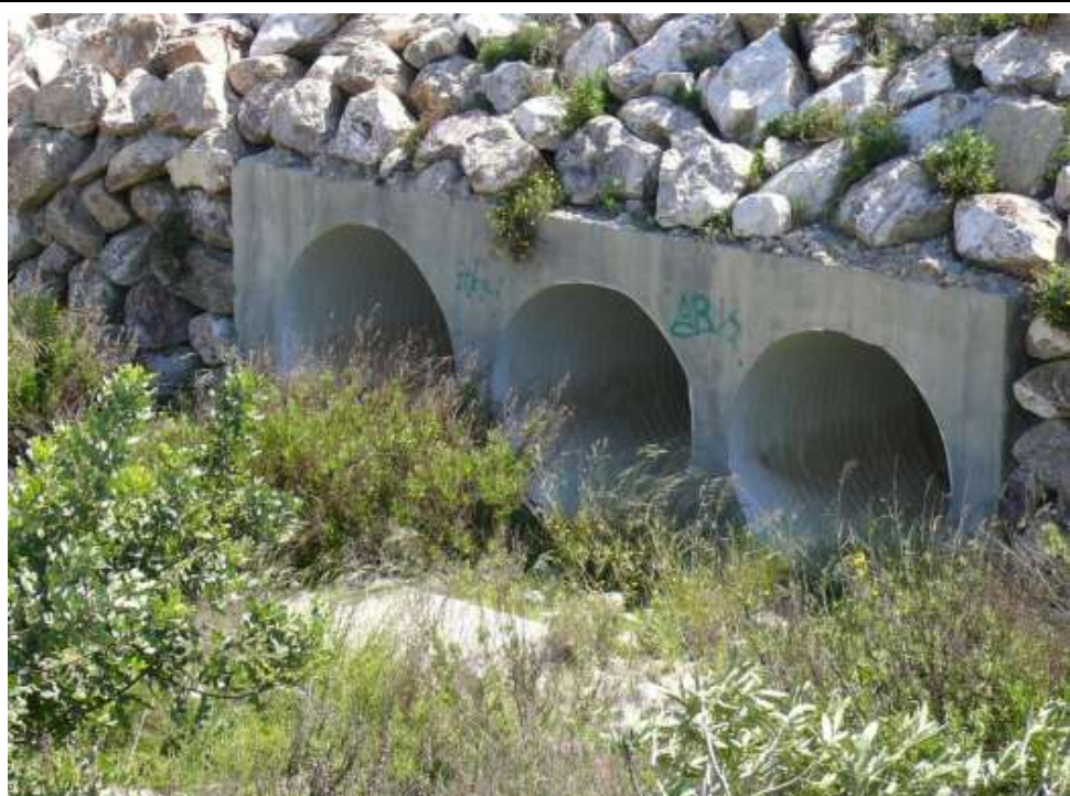
FOTO Nº34: Vista de obra de paso en cauce con tres tubos de PVC de 2.000 mm de diámetro recubiertos de escollera
