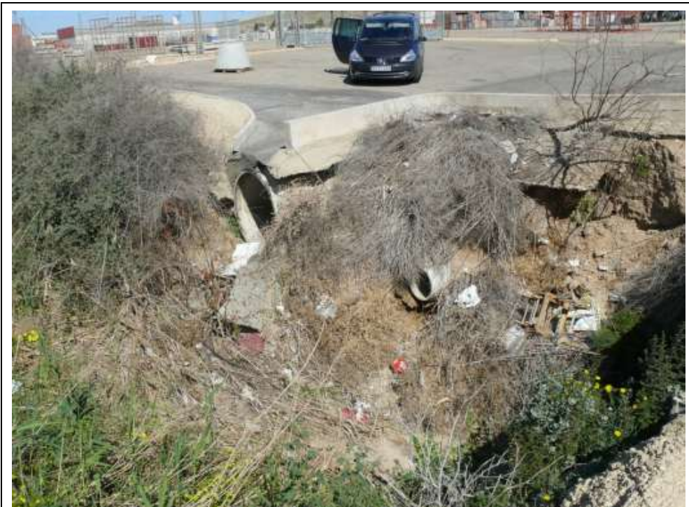
FOTO N°6: Vista vertido colectores a la Rambla del Algarrobo aguas arriba de Ctra. Las Cuevas
