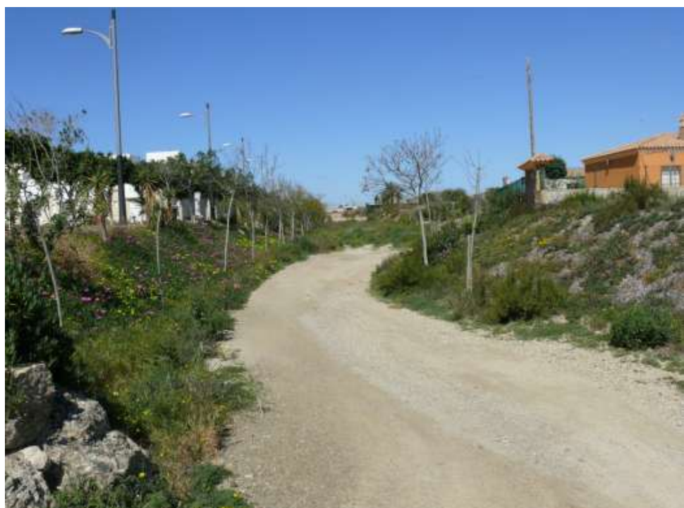
FOTO N°16: Vista desde el cauce hacia aguas arriba, solera en tierras y talud vegetal, con arbolado en solera.
